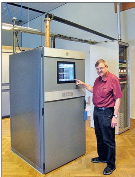
Jens Christian Seeberg ist der verantwortliche Techniker für den LW-Sender Kalundborg. Das oben aus dem Senderschrank herauskommende Rohr ist die Speiseleitung!
