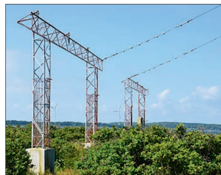
Die Drähte der Dachkapazität werden von den Turmspitzen nahe an den Erdboden geführt. Fotos: DL6AKC (2), Niels Dreijer (1)
